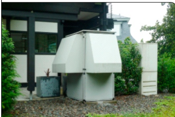
Luftwärmepumpe IDM TERRA 8CL neben der Garage
